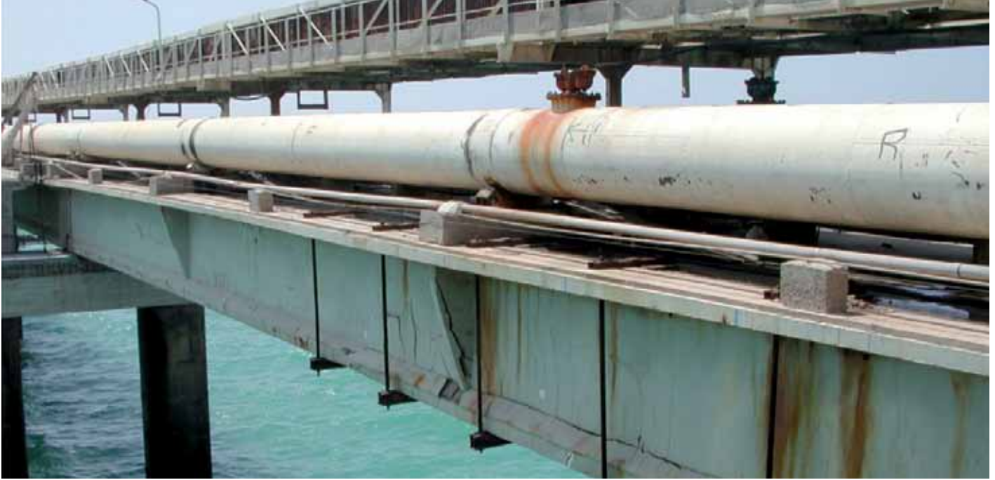
Les dégradations causées par l'environnement marin sur les ouvrages en béton sont très sévères.
