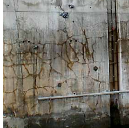
Les poteaux fissurés d'un pont victimes d'alcali-réaction.
